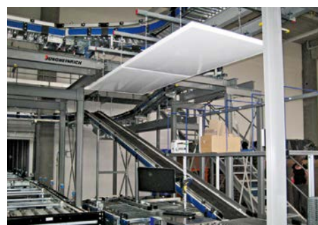
Eine Infrartheizung kann je nach Raumumgebung an der Wand oder wie an diesem Arbeitsplatz an der Decke installiert werden
